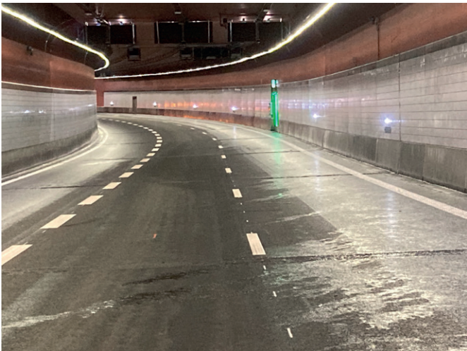
Mariefholmstunnel Göteborg Schweden
